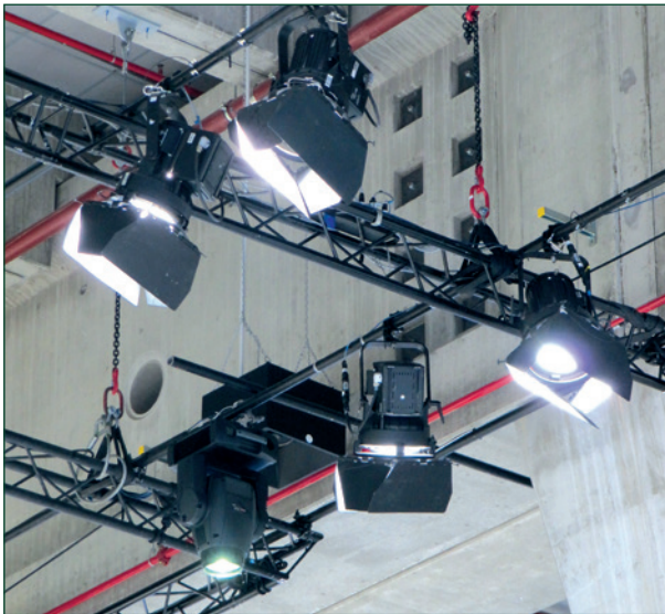
Perfektes Licht für die perfekte Show: Automobilmessen sind der klassische Einsatzort spezieller Vorschaltgeräte von B&S.
